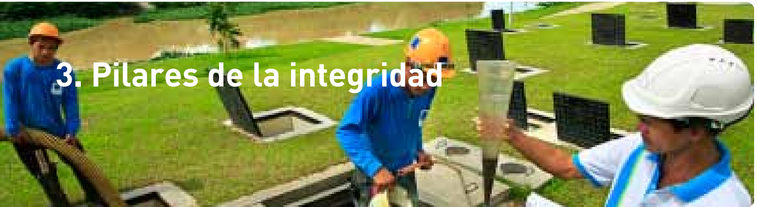
Tratamiento de aguas: parte de un esfuerzo para rehabilitar el río Pasig; una planta de tratamiento de aguas residuales fue construida en Marikina City (Filipinas), donde se tratan y reciclan las aguas residuales recogidas de establecimientos residenciales y comerciales. © Danilo Victoriano
